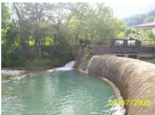
Foto 1 - Traversa e scarico min. deflusso vitale
